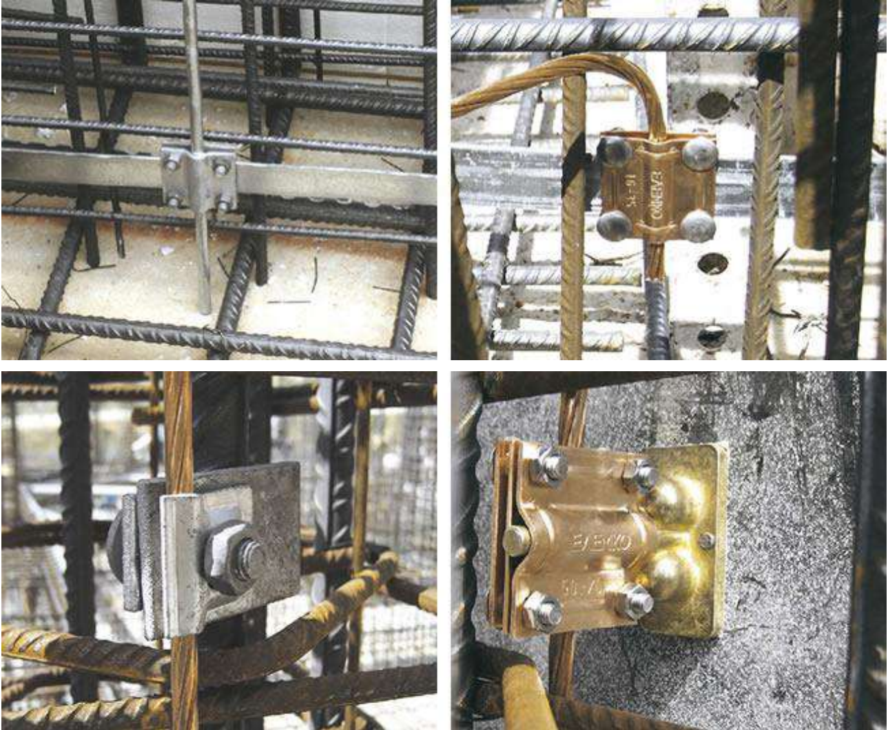
Figura 99 – Esempi di dispositivi di messa a terra delle armature di acciaio di elementi in c.a..
