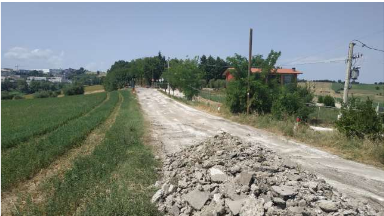
Figura 9 – Stato del tratto stradale in oggetto durante l'intervento di messa in sicurezza temporanea del luglio 2023 consistente nel ripristino della sovrastruttura stradale. A destra, il versante lato Nord; a sinistra, il versante lato Sud.
