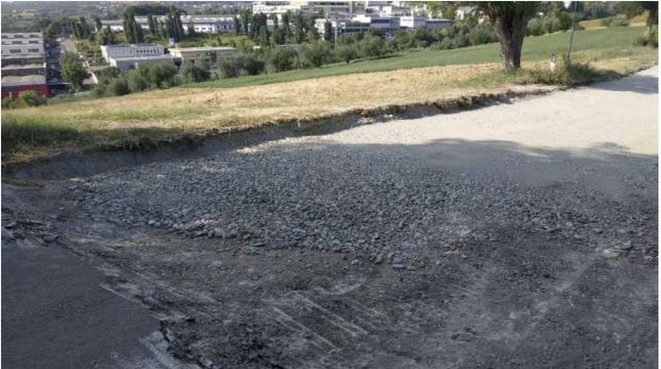
Figura 11 – Stato del tratto stradale in oggetto durante l'intervento di messa in sicurezza temporanea del luglio 2023 consistente nel ripristino della sovrastruttura stradale. Sullo sfondo, il versante lato San Marino.
