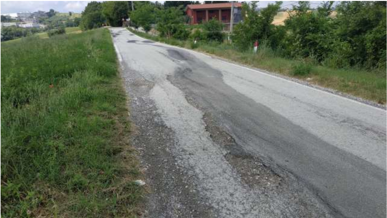
Figura 8 – Stato del tratto stradale in oggetto antecedentemente all'intervento di messa in sicurezza temporanea del luglio 2023. A destra, il versante lato Nord; a sinistra, il versante lato Sud.
