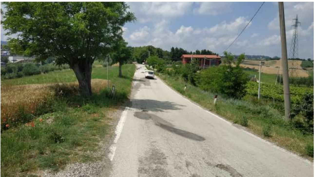
Figura 7 – Stato del tratto stradale in oggetto precedentemente all'intervento di messa in sicurezza temporanea del luglio 2023. A destra, il versante lato Nord; a sinistra, il versante lato Sud.
