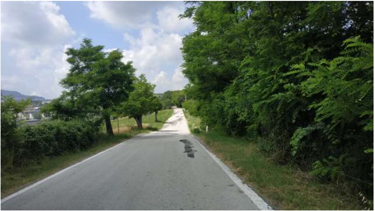
Figura 6 – Stato del tratto stradale in oggetto precedentemente all'intervento di messa in sicurezza temporanea del luglio 2023. A destra, il versante lato Nord. A sinistra, il versante lato Sud.
