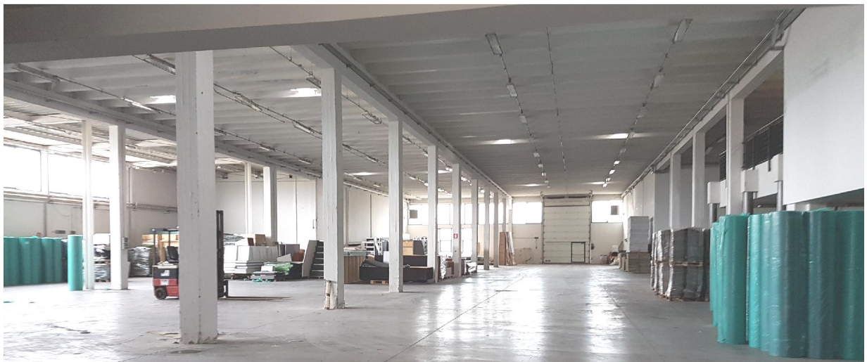
L'interno del capannone: notare la selva di pilastri e la struttura di copertura semplicemente appoggiata
